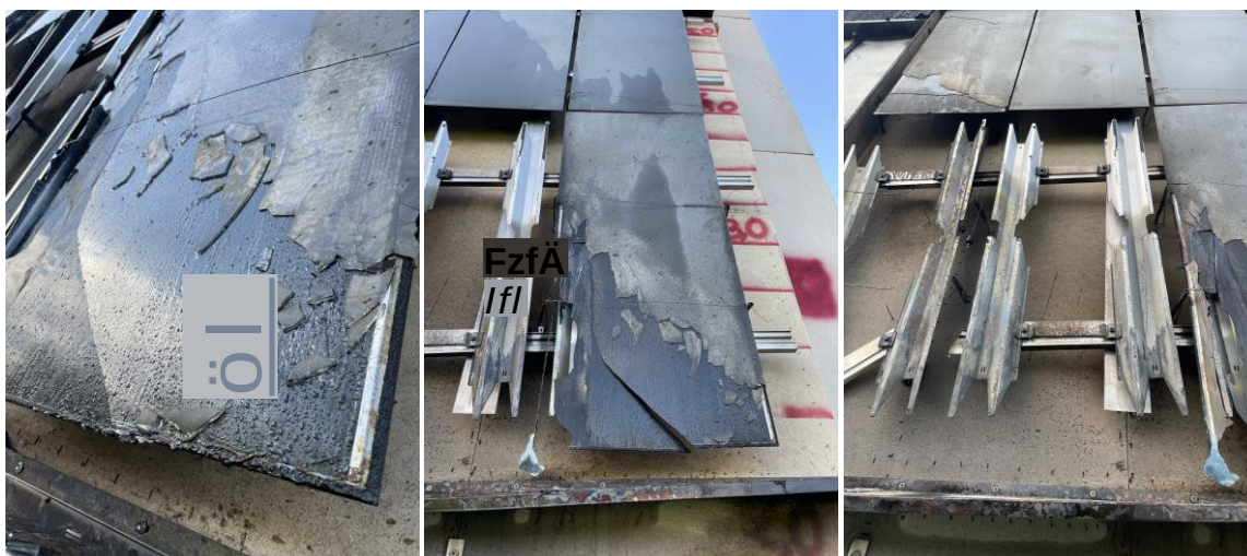
Abbildung 146: Schäden an der PV-Fassade nach dem Brandversuch
